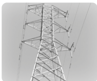
LIGNE HAUTE TENSION
