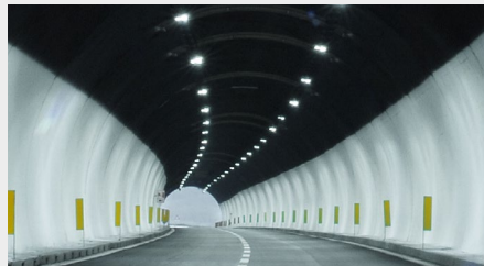
Iluminación de túnel
