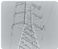
LIGNE HAUTE TENSION
